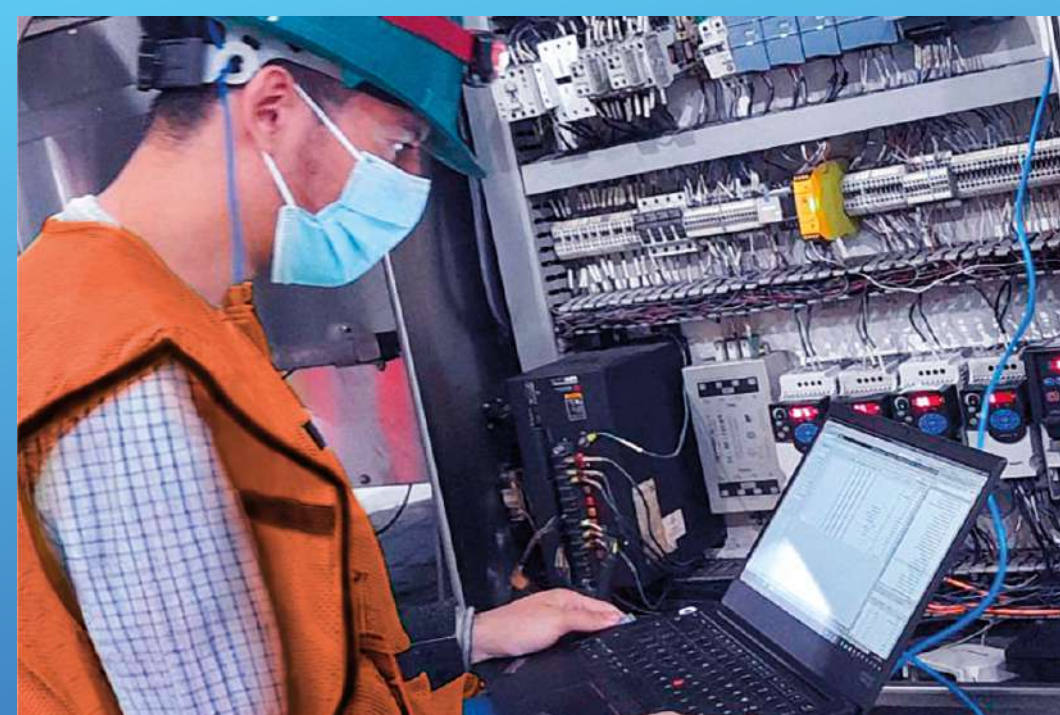
Servicio de programación PLC para automatización y control de actuadores neumáticos
