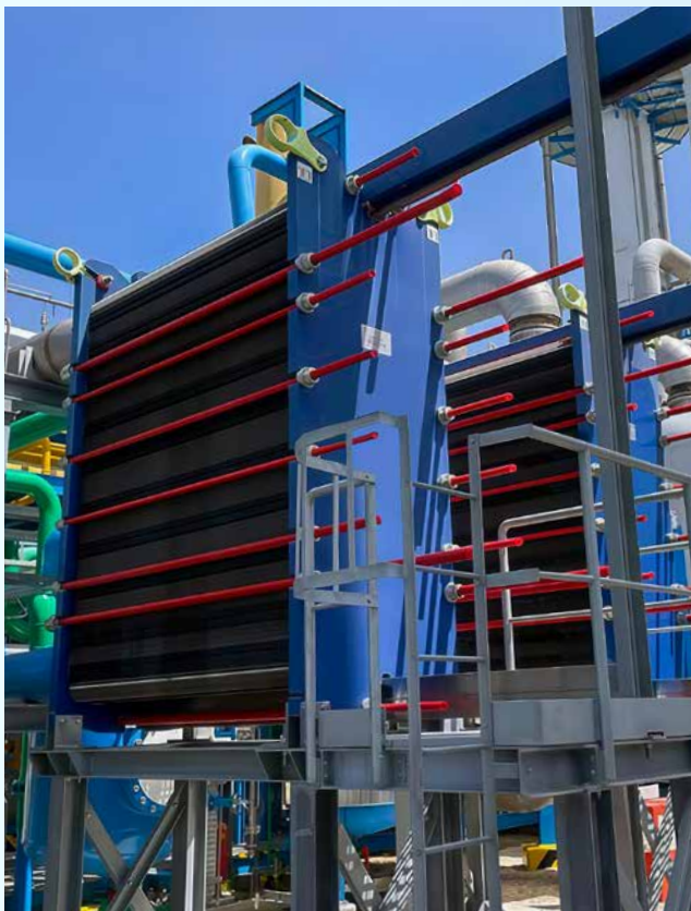
Servicio de mantenimiento en sitio para intercambiadores de calor - industria cementera
