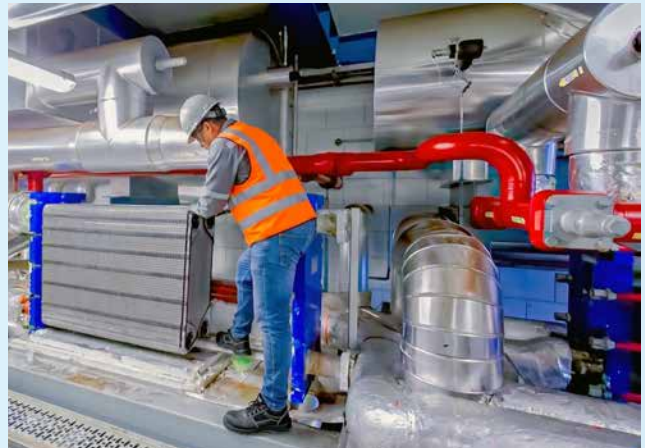
Actualización de placas y sellos de nueva generación servicio para intercambiadores GPHE
